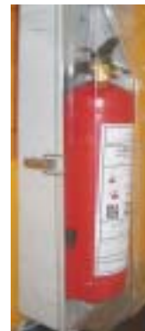
Extincteur dans boîtier
