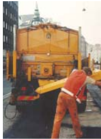
Extension de décharge par convoyeur de 2,2 m
